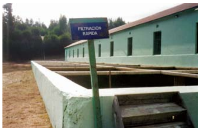
Fig. 24: Instalación de filtración rápida 31
