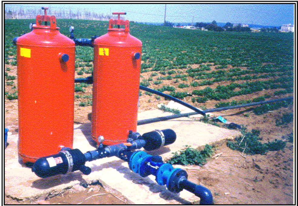
Photo 4 : Filtre à sable et filtre à tamis en irrigation localisé
