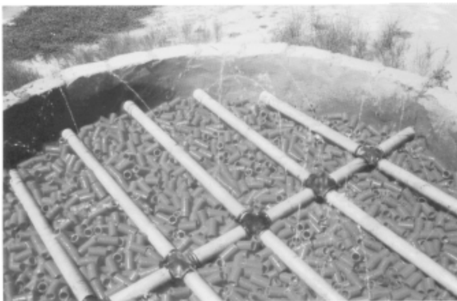
Abb. 8.4: Abwassersprenger über dem Tropfkörper
