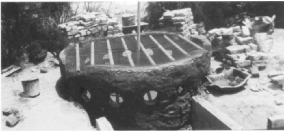
Abb. 8.3: Unterbau des Tropfkörpers
