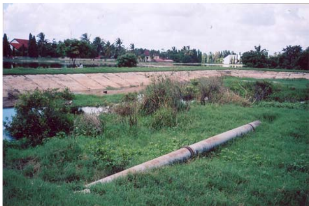
Abbildung 28: Zugeschlammter und bewachsener anaerobic pond der Teichanlage Msasani
