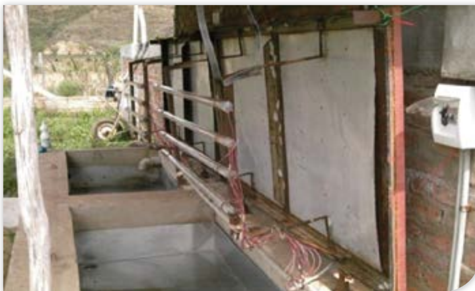
Foto 17: Desinfección mediante UV en la PTAR de Postrer Valle, Santa Cruz
