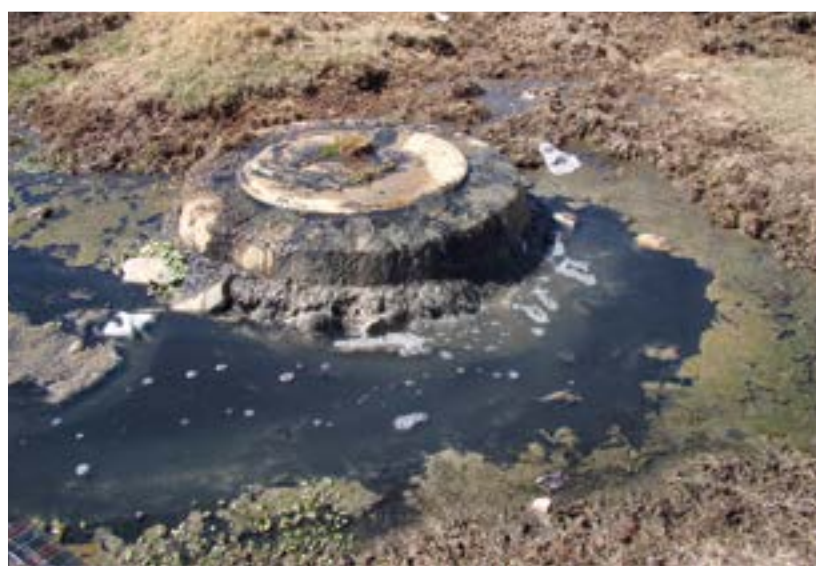
Vista del efluente del sistema de alcantarillado
