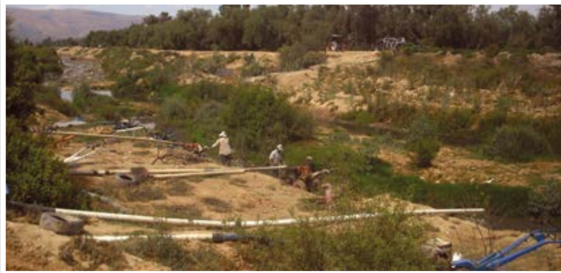
Bombeo de las aguas residuales para su uso (sindicato de bomberos)
