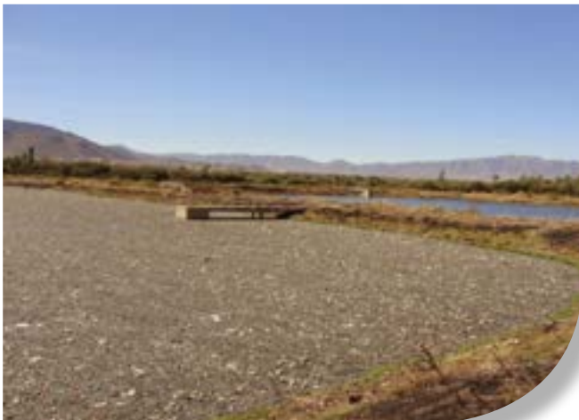
Foto 21. Laguna anaeróbica colmatada por falta de mantenimiento y fallas en el pre-tratamiento (PTAR San Luis, Tarija)
