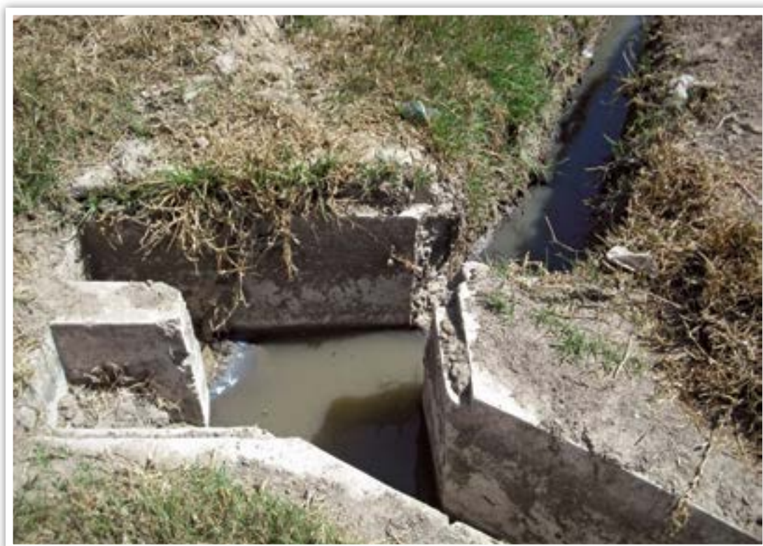
Acequia desviada con agua servida
