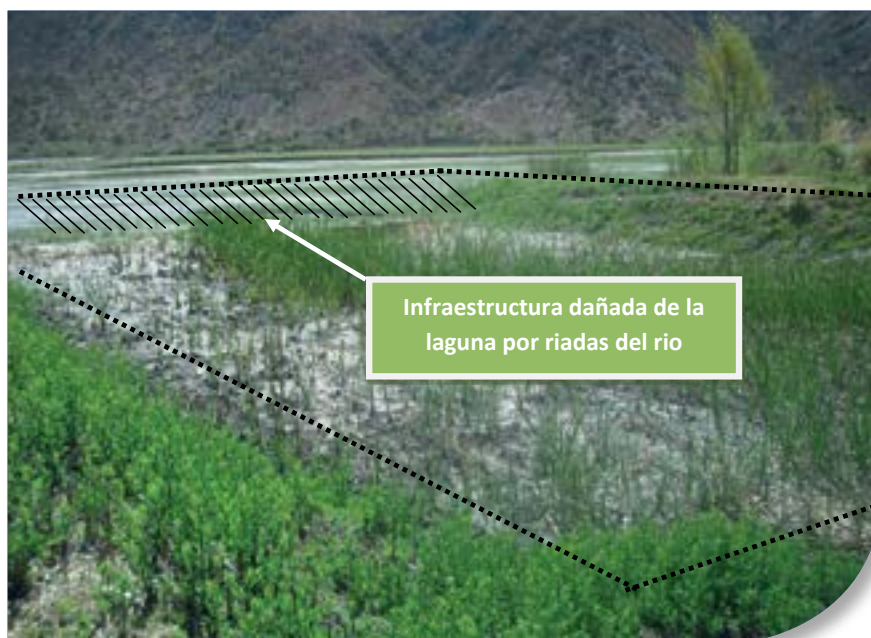
Foto 22. Laguna destruida por las riadas - problema de la construcción; Capinota, Cochabamba
