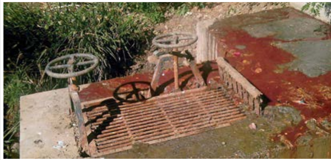
Vertido del afluente debido a la colmatación en la cámara de rejillas
