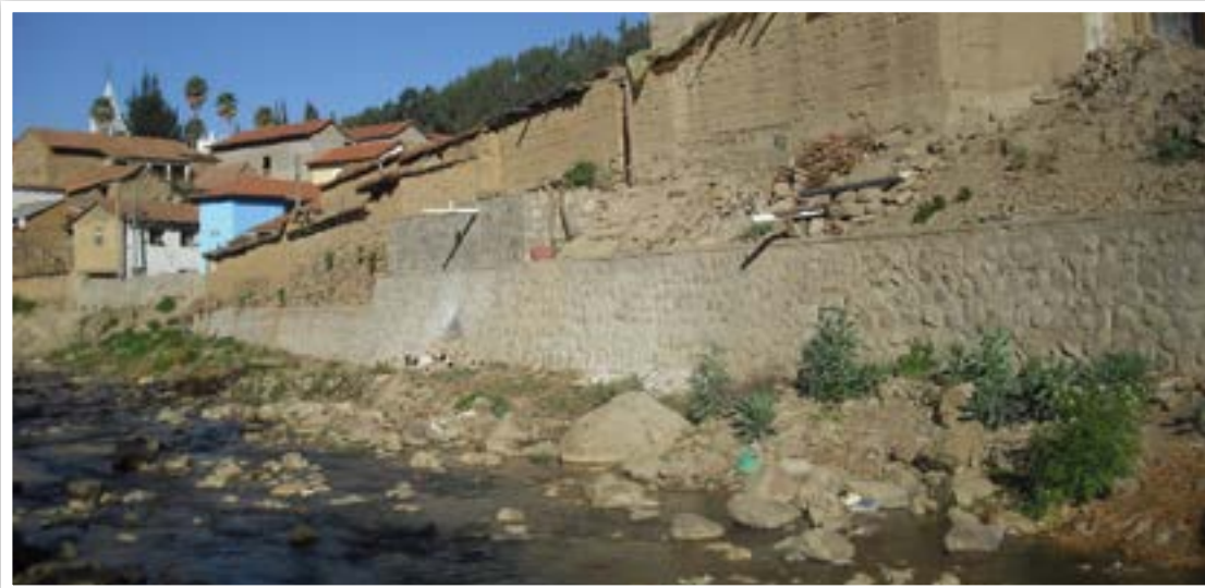
Conexiones de las viviendas hacia el Río Totora
