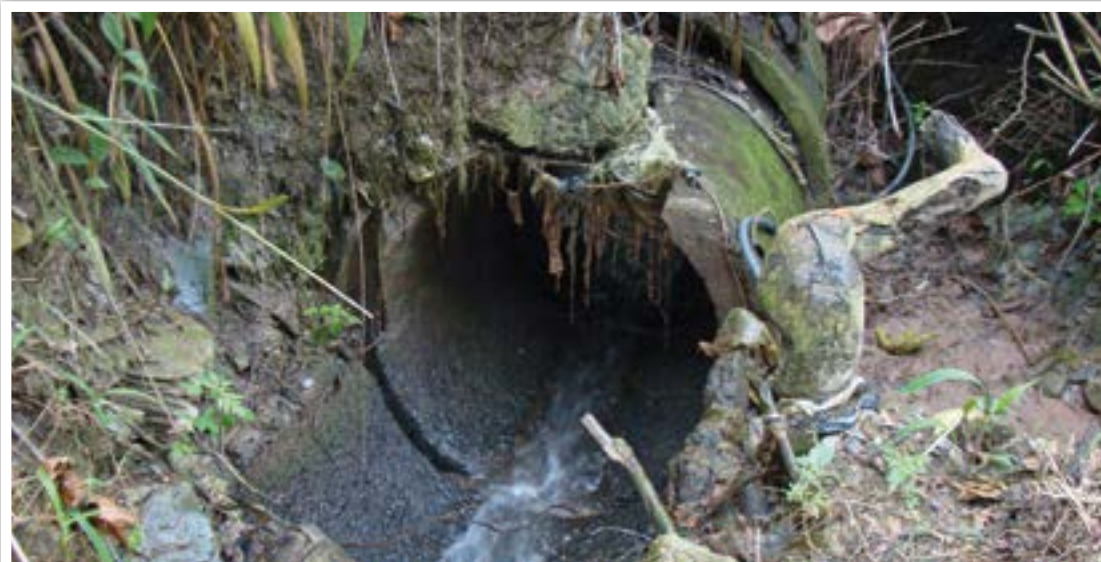
Vista del efluente del sistema de alcantarillado
