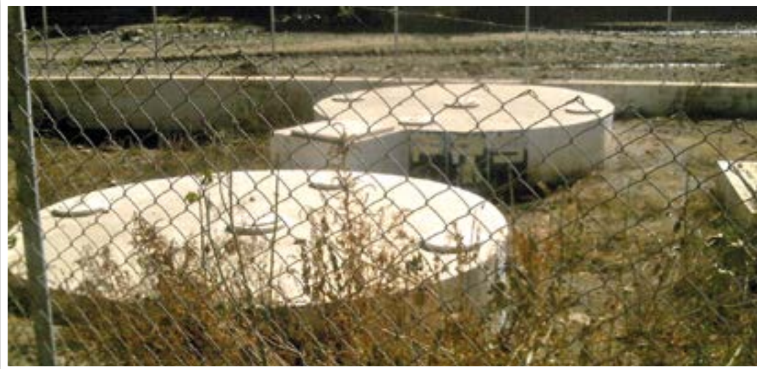
Tanques PTAR OTB Palca
