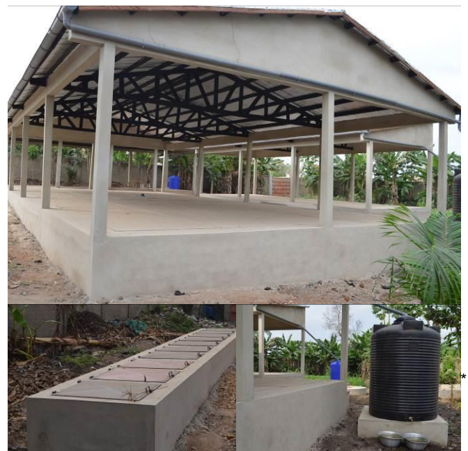
Fig. 10: Hangars, lits de séchage et systèmes de récupération d'eau de pluie du site de compostage de Lokossa (source: E. Albert, 2014)
