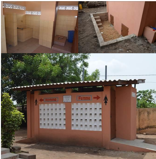
Fig. 9: Latrines EcoSan publiques au sein de la Mairie de Lokossa (source: A. Dubois, 2014)
