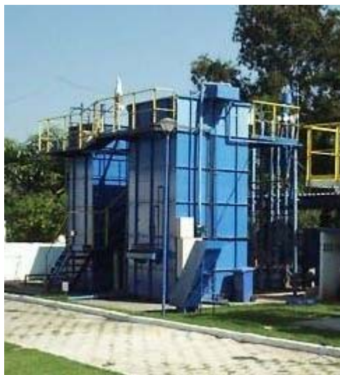
UASB seguido de Biofiltro Aeróbio (UFES)
