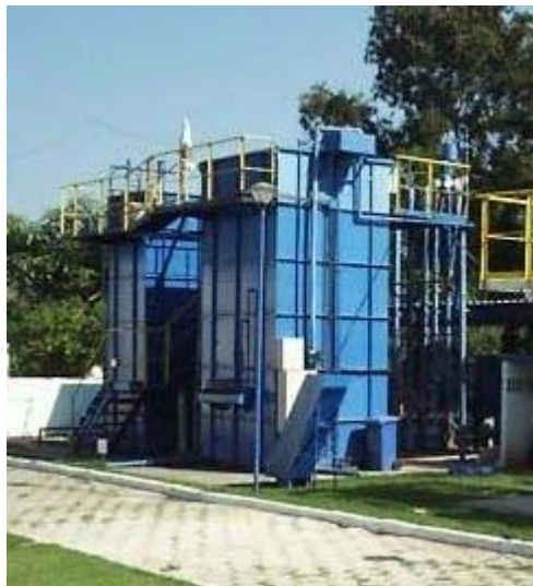
UASB seguido de Biofiltro Aeróbio (UFES)
