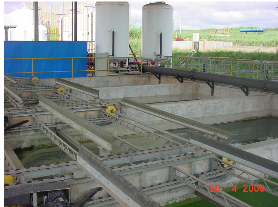
Sistema de Polimento da ETE Samambaia (DF) – 150 mil hab.
