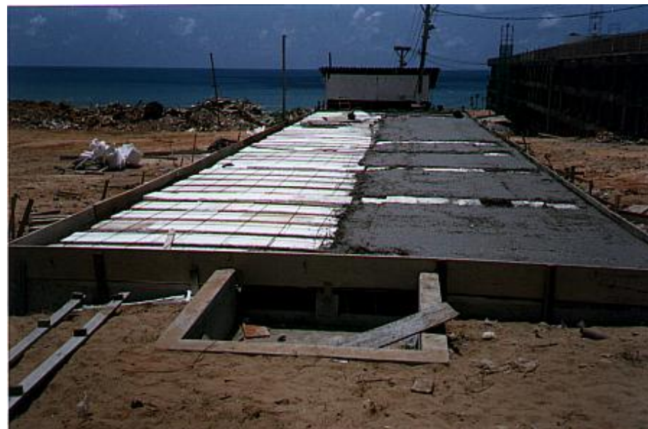
Decanto Digestor com Filtro Anaeróbio (Natal - RN) 1.000 hab.
