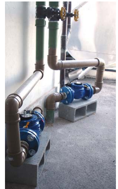
Hidrômetros com saída de sinal
