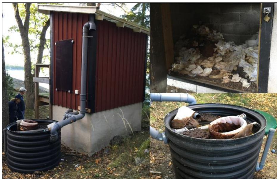
Kuva 36. Saarisäätiöllä on käytössä myös neljä itsekehitettyä Lasse-vevoa, joissa on nesteelle ja kiinteälle jätteelle erilliset käsittelysäiliöt. Kuvassa Saarisäätiön kohteella oleva Lasse-käymälärakennus, jonka ulkopuolella on mullalla täytetty virtsasäiliö. (vasen ja oikea ala) ja käymälän alla oleva tila kiinteän jätteelle (oikea ylä). (Ehn, n.d.)
