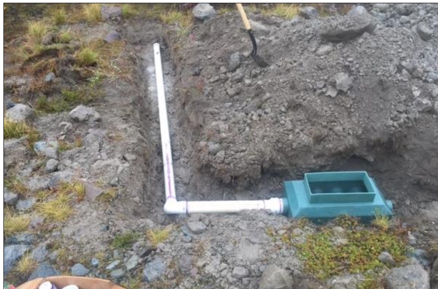
Kuva 17. Maimeyttämön perustamisvaiheessa asennetaan maimeyttämön putki ja virtsan seisotusastia maaperään. (Toilet tech solutions, n.d.c.).
