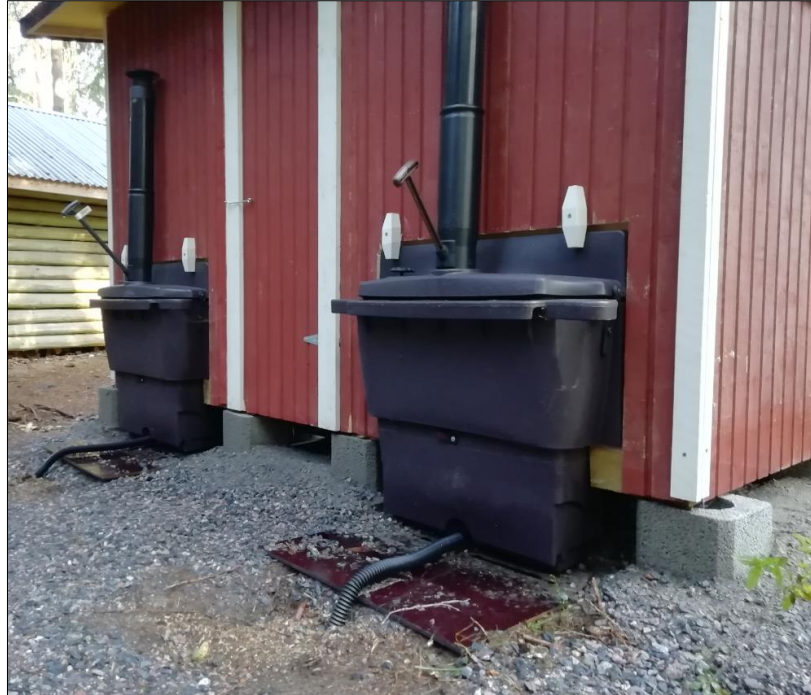
Kuva 47. Toisissa käymälöissä ilmanvaihtoputket ulottuvat vain räystäään alle, joka voi heikentää kuivakäymälän ilmanvaihtoa. Kuvasta nähdään myös suotonesteputkien upotus maaperään. Kohde Siipoonkorven kansallispuistossa Ängesbölen nuotiopaikalta. Kuva: Lauri Värri.
