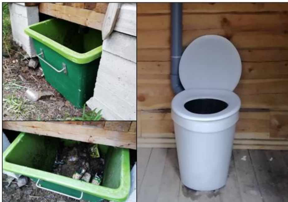
Kuva 63. Yksi Pyhä-Luoston alueen ylikuormittunein ja rakenteeltaan poikkeava kuivakäymälä sijaitsee Ahvenlammen virkistyskalastuskohteen yhteydessä. Kuvassa nähdään, miten käymäläjätelaitikko on jouduttu sijoittamaan kuoppaan (vasen ylä) ja käymäläjätteen sekaan kertyy paljon roskia (vasen ala). Käymäläistuimen poikkeava rakenne sekä ilmanvaihdon poistoputki kuvattu kuvan oikeassa laidassa.
