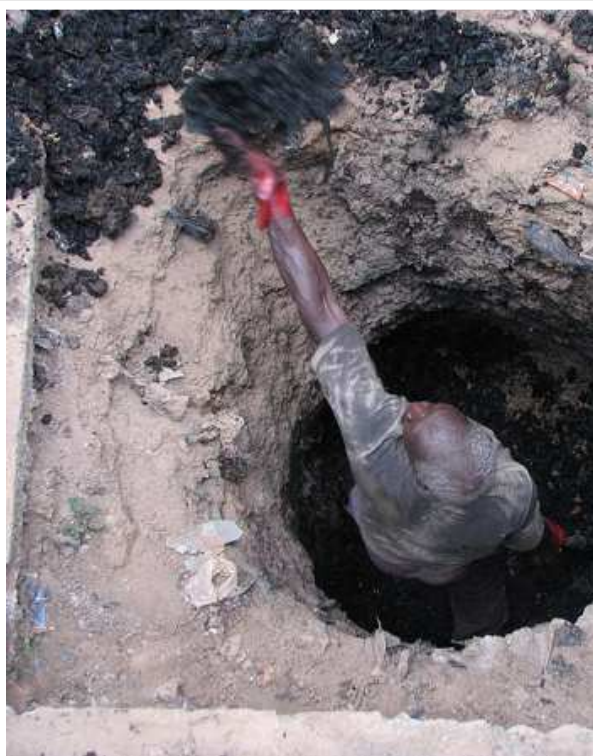
Photo 23 : Les gazes nocives et les objets coupants mettent gravement en danger la santé des vidangeurs - surtout de ceux qui pratiquent la manière manuelle.
