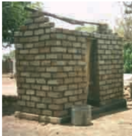
Photo 4-28 : Latrine composteuse à double fosse avec une superstructure en briques
