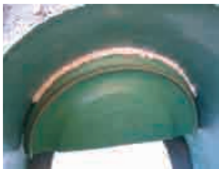
Photo 6-25 : Le séparateur d'urine est scellé aux parois du seuil
