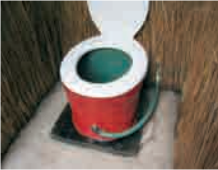
Photo 6-31 Siège à séparation d'urines installée.
