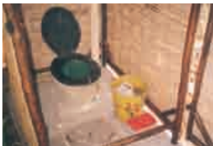
Photo 4-18 : L'intérieur d'une Fossa alterna équipée d'un siège
