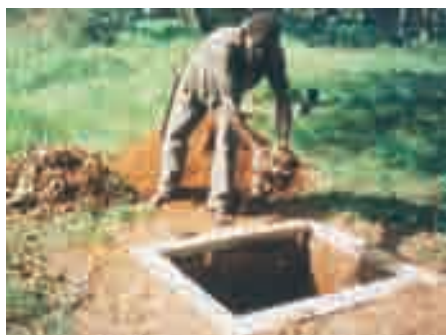
Photo 4-11 : Ajout de feuilles dans la fosse de la Fossa alterna
