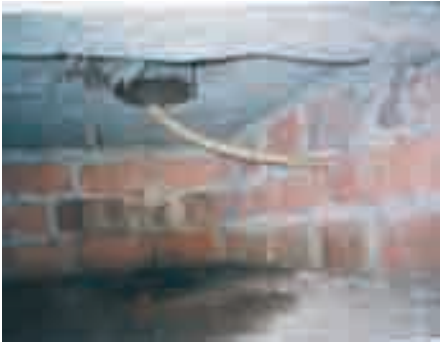
Photo 6-37 : Le tuyau en plastique achemine l'urine depuis le siège
