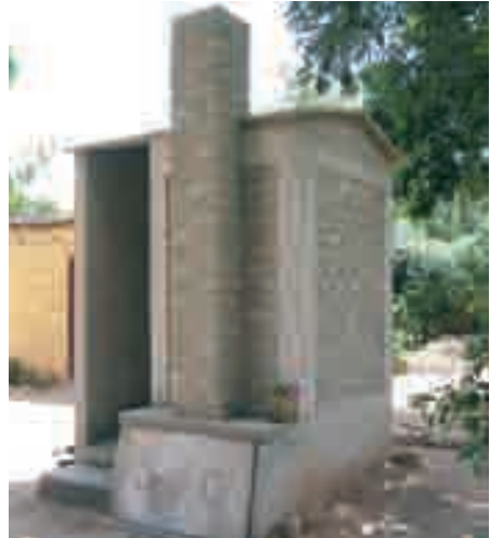
Photo 6-42 : Une latrine à déviation d'urine à une fosse
