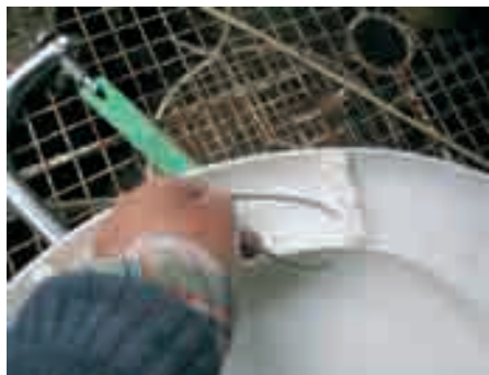
Photo 6-15 : Utilisation d'un fil de fer chaud pour percer les supports du siège de la latrine
