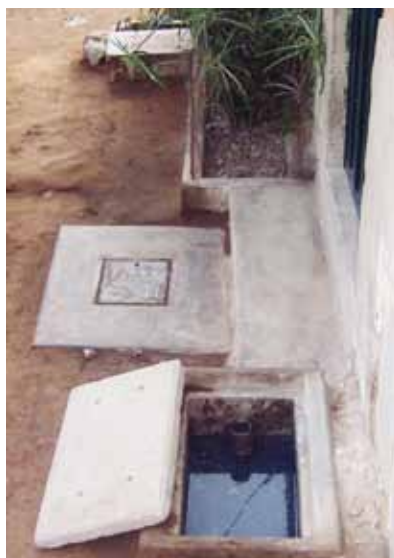
Foto 10: Cámara atrapagrasas y humedal artificial del subsistema domiciliario. Asociación de Vivienda Los Topacios, Nievería. Lima
