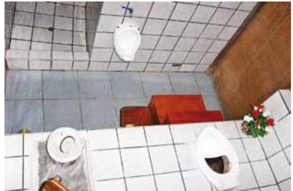
Foto 8: BES de doble cámara con ecoinodoro empotrado
