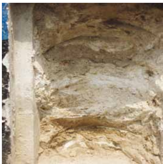
Foto 19: Estratos del material saneado en la cámara
